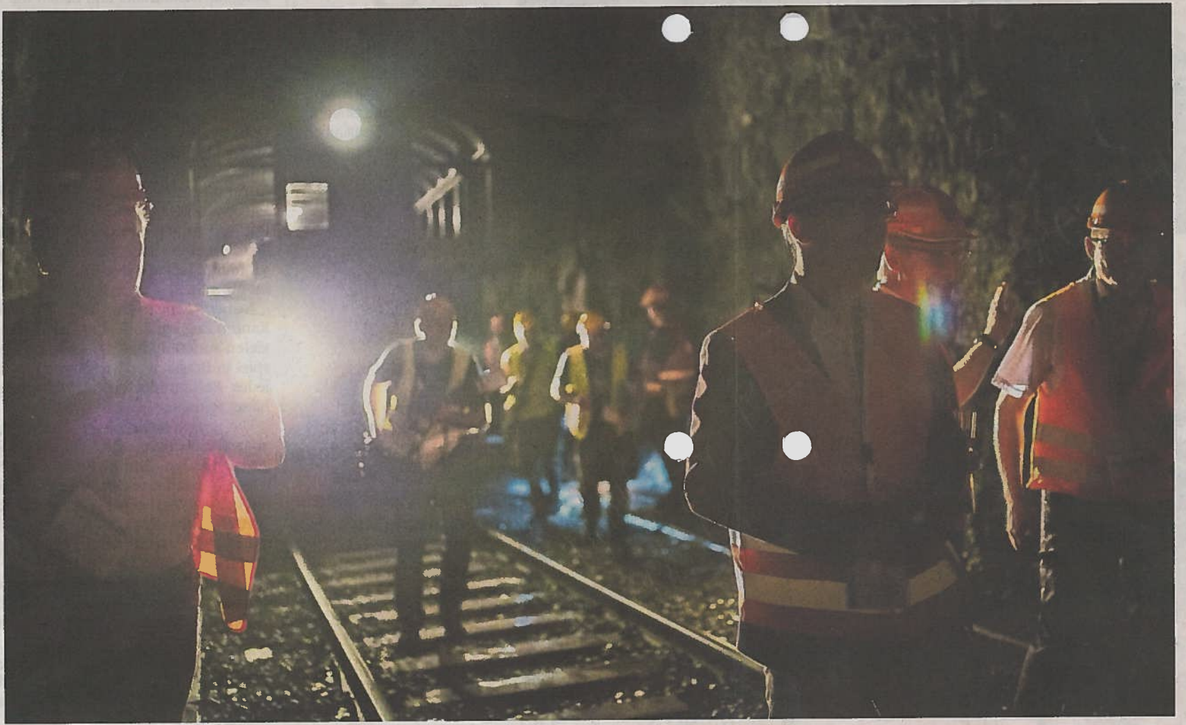
Gang durch den Weissensteintunnel. Dieser ungewöhnliche Augenschein offenbarte den Zustand des Tunnels.
