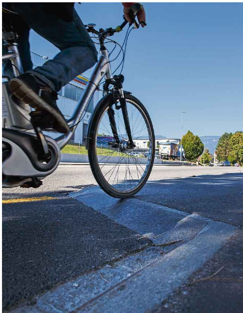
Die Übergänge auf den Radwegen wurden während der Sanierungsarbeiten an der Solothurn- und der Enggestrasse zwischen 2015 und 2017 eingebaut und führten zu etlichen Reklamationen.
